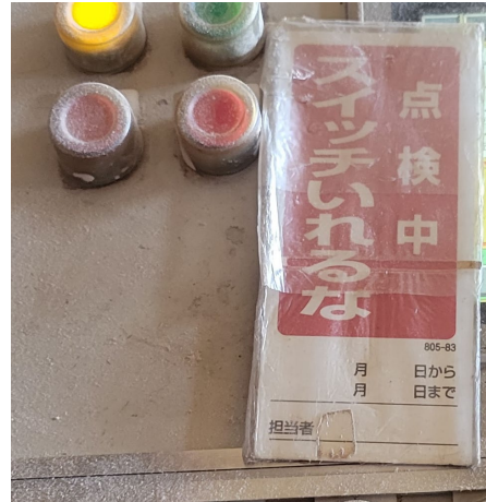
点検作業時の明示
