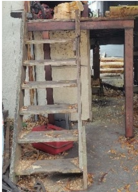
手摺りの未設置
